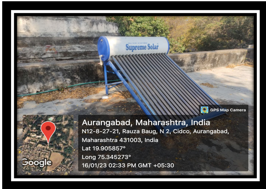
Solar Panel ( Boys Hostel)
